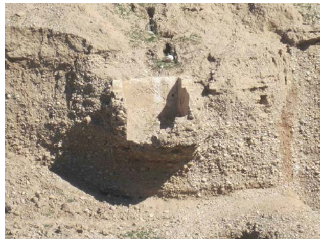
تصویر ۴. قسمتی از سقف فرو ریخته پل‌بند. عکس: حسن اکبری، ۱۳۹۲. Fig. 4. The collapsed roof of Polband. Photo: Akbari, H., 2013.
