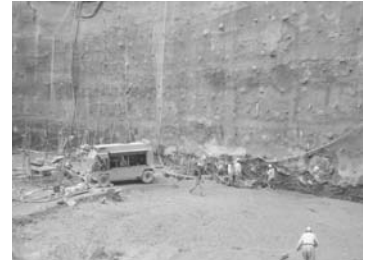
تصویر ۹- پایدارسازی جداره گودبرداری از خارج گود - روش میخ کوبی. (مأخذ: نگارنده)
