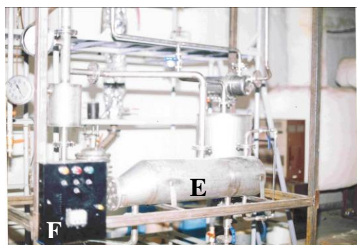
شکل ۴- تصویر از روبرو و قسمت پایین واحد تقطیر E- ریویلر، F- جعبه الکتریکی کنترل بار حرارتی ریویلر
