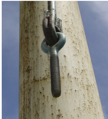
شکل ۳- شکست ترد بست‌های قورباغه‌ای مهاربندها [۱]
