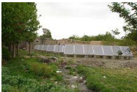
تصویر شماره (۳): نمایی از حمام خورشیدی نصب شده در روستای فهندر خراسان
