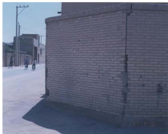
شکل 3. جابه‌جایی نسبی قسمتهای مختلف دیوار حیاط نسبت به هم و ایجاد گسیختگی در محلهای تمرکز تنش (شهرک امام جعفر صادق)
