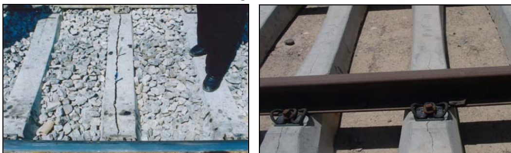
شکل ۳. ایجاد ترکهای طولی در تراورس‌های بتنی پیش‌تنیده B70 قبل و در هنگام بهره‌برداری
