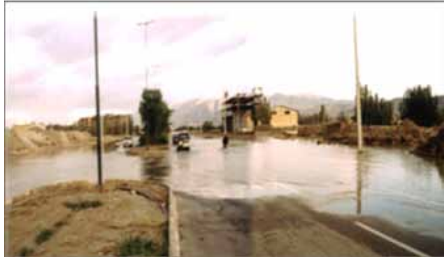
شکل ۷: عدم زه کشی مناسب آبهای سطحی در پست ترین نقطه شهر (بین دوشهر)
