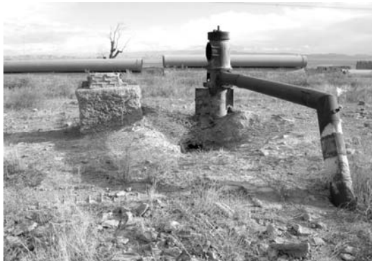
شکل ۱۱- لوله‌زایی در اثر نشست زمین در بخش شمال غربی دشت مشهد در مقایسه با عکس شماره ۱۰ پس از ۴ سال. شرکت آب منطقه‌ای خراسان رضوی (۱۳۸۸).
