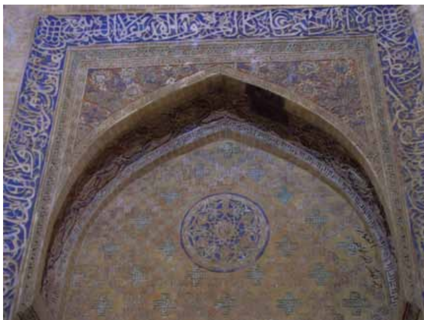
تصویر ۱۵- کلمه‌ی الملک و علی، کوفی بنایی، تزیینات آجر کاری، مقابر گنبدسبز، مقبره خواجه علی صفی.
