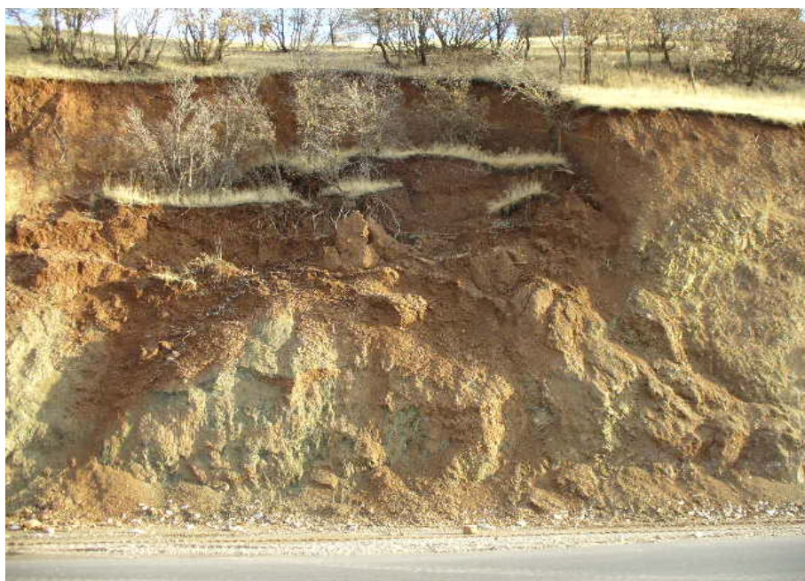
شکل ۱۲- نمونه‌ای از لغزش که در اثر زیر بری دامنه به وسیله احداث جاده صورت گرفته است
