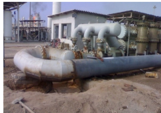
شکل ۲- خوردگی در خط لوله ۱۸ اینچی کارخانه.
