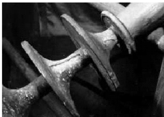
تصویر (۵) : خوردگی سایشی (erosion) در یک مقره کامپوزیتی در اثر آلودگی شدید محیط [۸]
