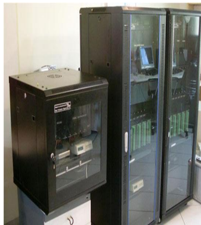
شکل (1): نمونه ای از تجهیزات منصوبه در پایانه های راه دور مخابراتی (RTU) بعنوان اجزای غیر سازه ای
