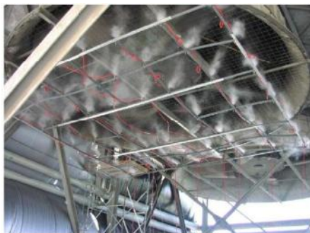
شکل ۱۶: نمونه نازل های اسپری نصب شده
