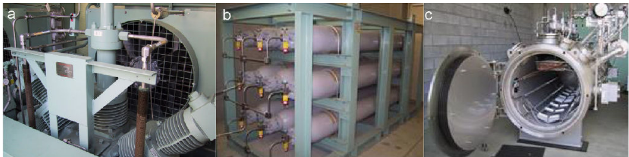
شکل ۸- (a) کمپرسور هیدروژن فشار بالا (b) بانک ذخیره سازی مخازن هیدروژن فشار بالا (c) اتاق کنترل درجه حرارت
