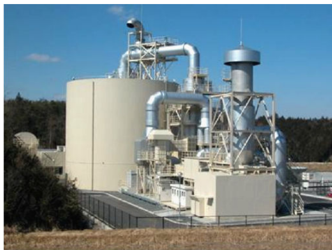
شکل ۵- عکسی از یک ساختمان تست آتش که درون آن نسبت به انفجار مقاوم است.
