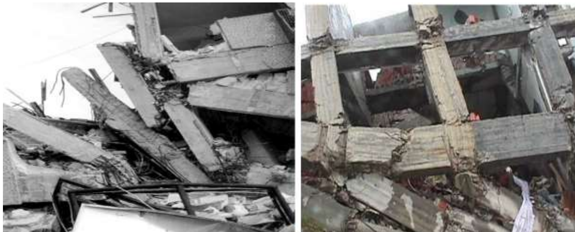
شکل ۱: خرابی اتصالات در زلزله ۱۹۹۹ کوچی ترکیه
