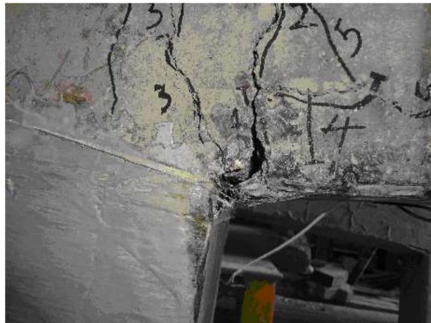
شکل ۳: خرابی تیر BS1 در اثر پارگی GFRP دور پیچ
