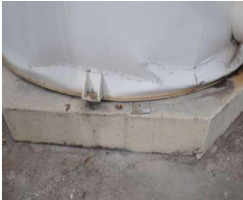
شکل ۱: لغزش انکربولتهای تانک مهارشده در زلزله ۲۰۱۰ شیلی با بزرگای ۸/۸
