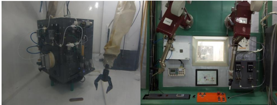
شکل ۴- خط تولید نصب شده در آزمایشگاه هات سل
