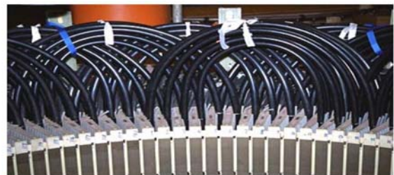
شکل ۸ - سیم پیچی های انتهایی در ژنراتورهای کابلی
