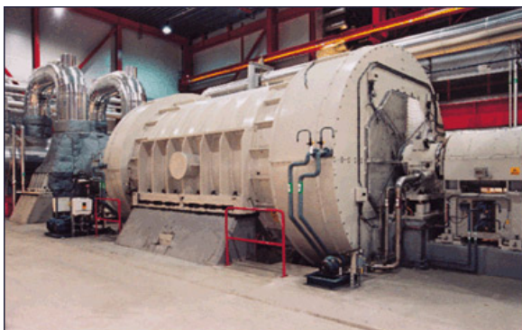
شکل ۹ - نمایی از ژنراتور کابلی نصب شده در واحد Eskilstuna
