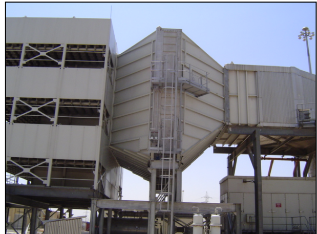
شکل (۸) داکت عبوری هوا در سیستم مدیای نصب شده در نیروگاه سیکل ترکیبی فارس
