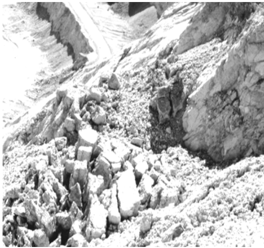
شکل ۵- تصویر ناحیه در حال تغییر شکل و گسیختگی در پای پله .
