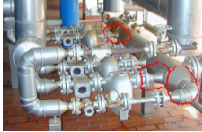
شکل 6- اتصال نادرست شاخه فرعی به اصلی کاندنس برگشتی
