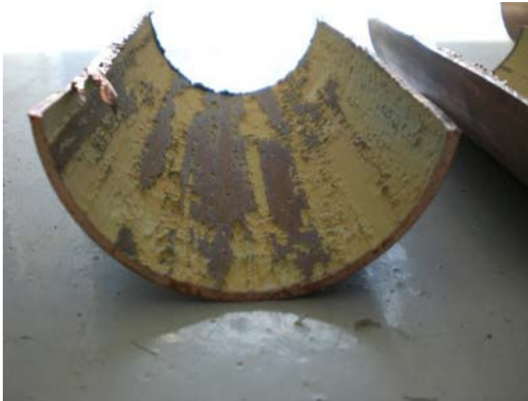
شکل 4- نمونه تخریب ایجاد شده روی یک لوله توسط پدیده خوردگی-سایش
