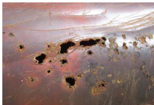
شکل 5- نمونه ای از تخریب های ایجاد شده توسط خوردگی گالوانیک
